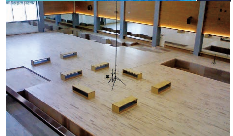
熱画像(冷房時体操場) 熱画像から床面、壁面が均一な温度になっており予定通りのふく射効果が発揮されている
